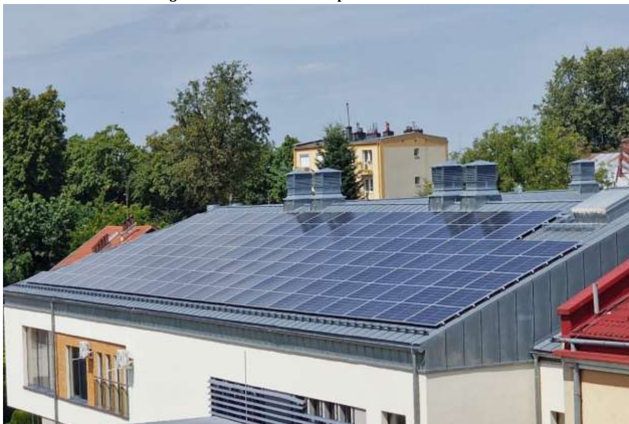
Fotografia 137. Zamontowane panele fotowoltaiczne
