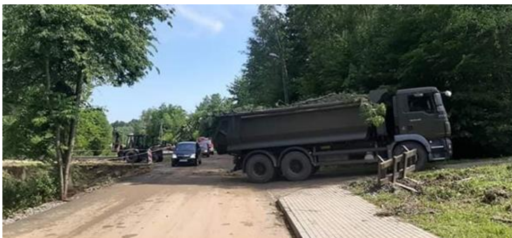
Fotografia nr 47. Usuwanie skutków powodzi
