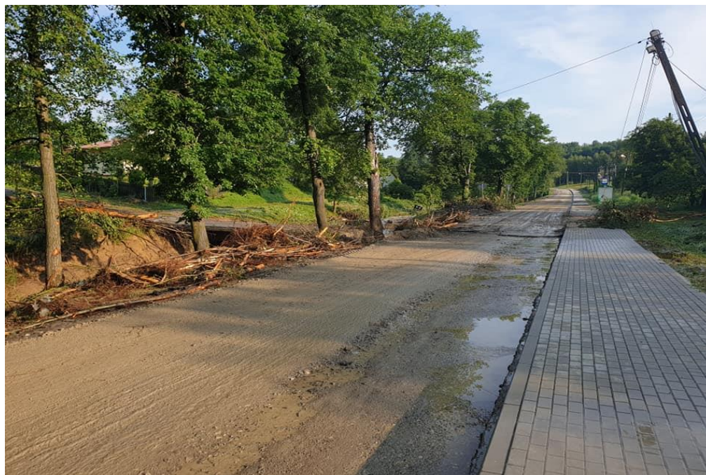
Fotografia nr 43. Zniszczona droga powiatowa nr 1546R w Tarnawce
