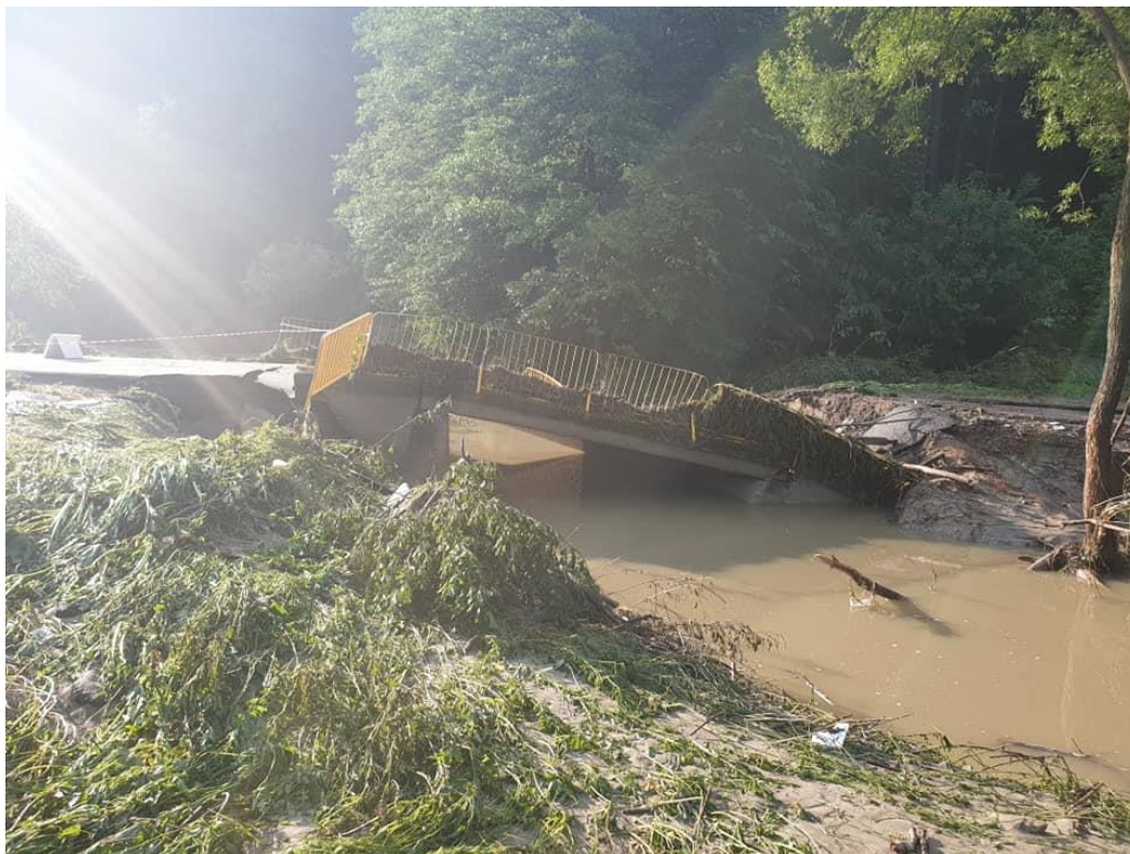
Fotografia nr 46. Zniszczona droga powiatowa nr 1546R i most w Tarnawce
