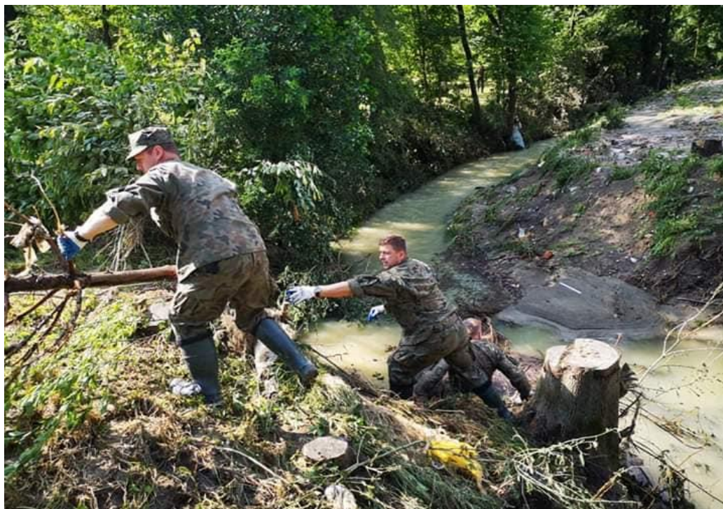
Fotografia nr 50. Usuwanie skutków powodzi
