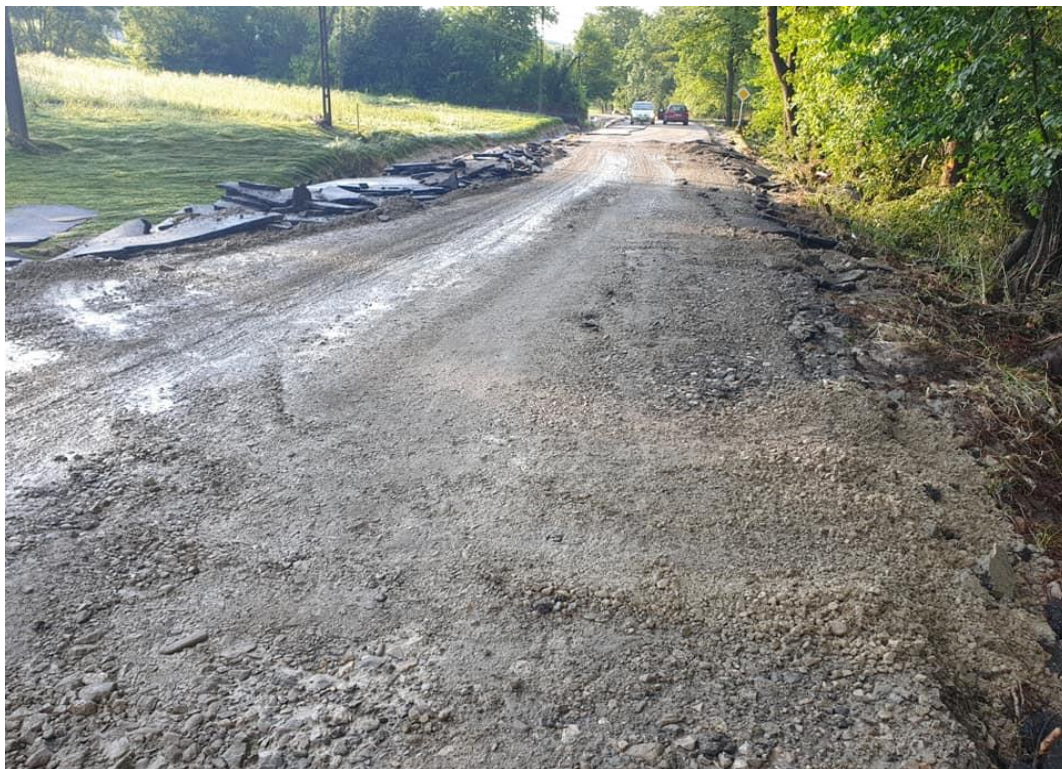
Fotografia nr 44. Zniszczona droga powiatowa nr 1546R w Tarnawce
