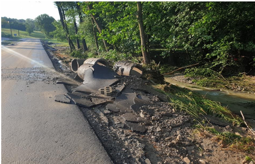
Fotografia nr 45. Zniszczona droga powiatowa nr 1546R w Tarnawce
