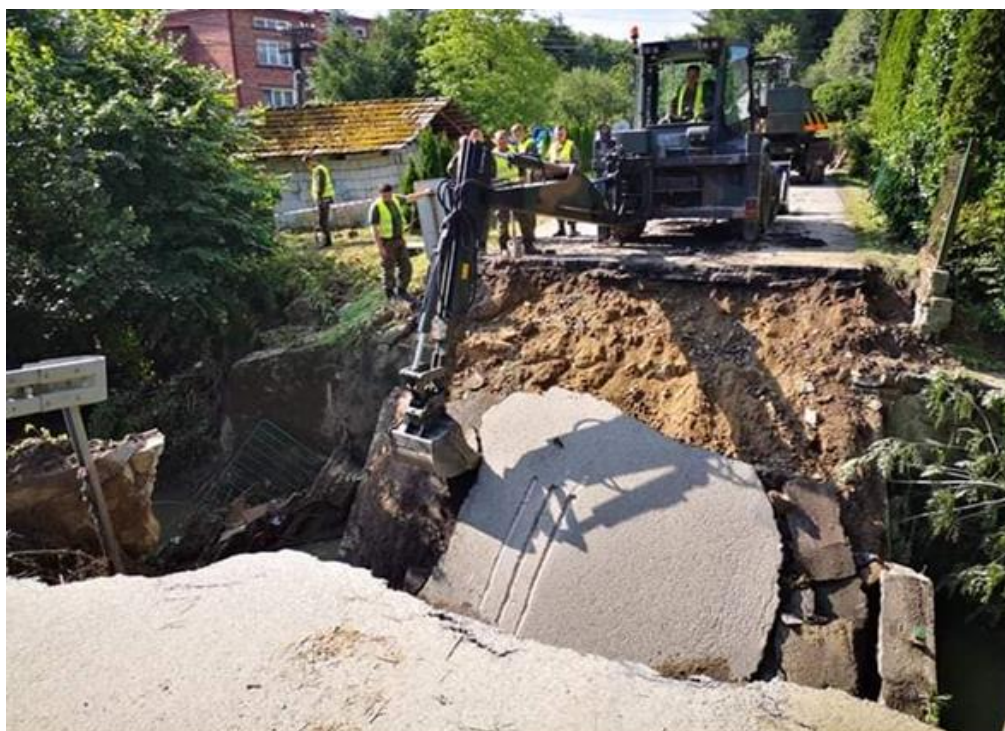
Fotografia nr 48. Usuwanie skutków powodzi
