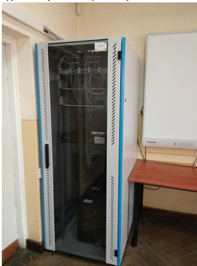
Zdjęcie nr 14. Zakupiona szafa serwerowa w pracowni komputerowej w Zespole Szkół Nr 2 w Łąncucie.
